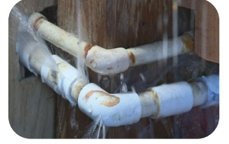
Kış aylarında su borularının patlaması
