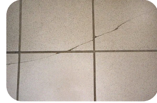
Sıcak günlerde fayanslarda çatlaklar oluşması
